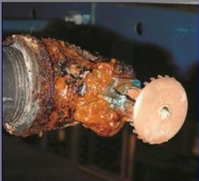
Fallas en los rociadores automáticos
